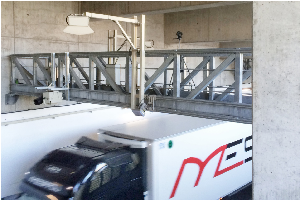
Bild 6: Installationen für das Gefahrgutmonitoring am Simplonpass
