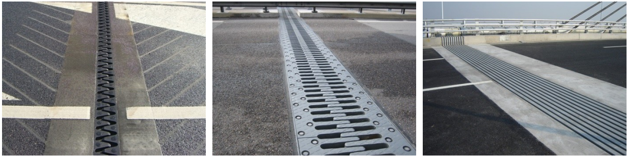
Abbildung 3.12 Beispiele für Fingerübergänge (links und Mitte) und Lamellenübergang (rechts), Quelle: Homepage der Fa. mageba SA, Bülach
