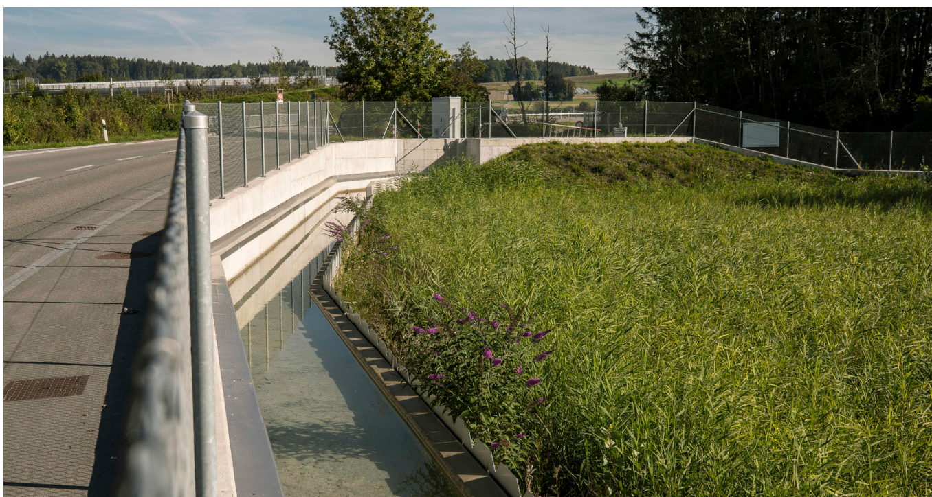
Wie die SABA Grütwisen bei Zürich Affoltern reinigt die SABA Limmattal in Zukunft das Strassenabwasser.
