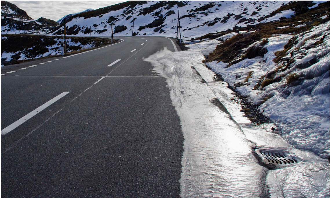
Abb. 71: Vereiste Fahrbahn aufgrund ungenügendem Schmelzwasserabfluss
