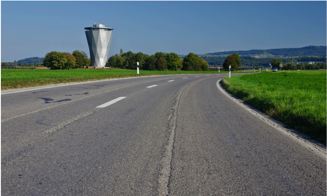
Abb. 63: Spurrille fahrstreifenmittig (aufgrund unsachgemässes Deckbelageeinbau)
