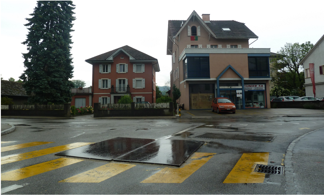
Abb. 36: Schlechtes Beispiel einer Grabenabdeckung
