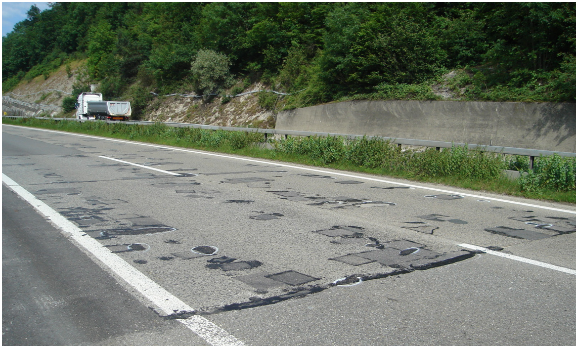
Abb. 57: Flickenteppich nach mehrmaligen Belagsreparaturen
