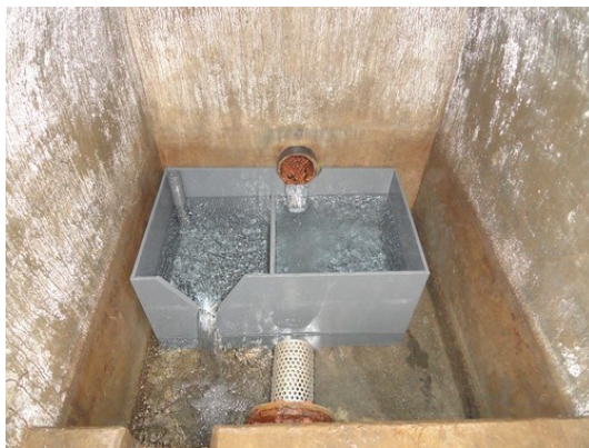
Abb. 7.64 Messwehr in einer Quelfassung [112]
