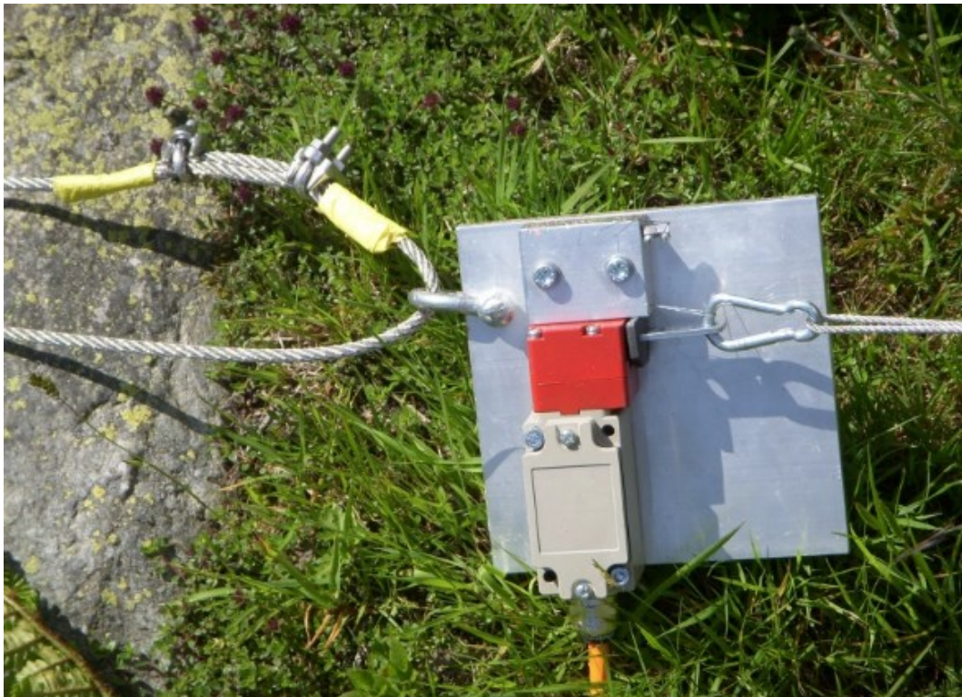
Abb. 7.42 Reissleinschalter zur Überwachung eines Murganggrabens [71].
