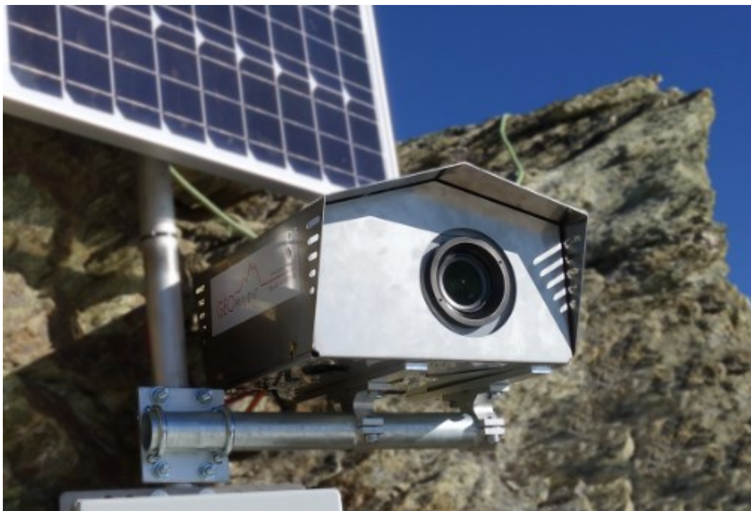
Abb. 7.47 Deformationskamera mit Solarpanel zur Stromversorgung [57]
