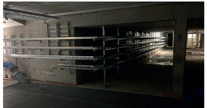
Kabeltrassen an den Wänden nehmen kilometerlange Kabel auf.
