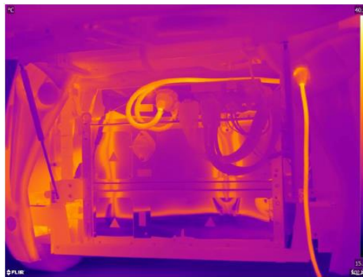
Figure 12 - Niveau d'échauffement du câble après 30 minutes (30°C)
