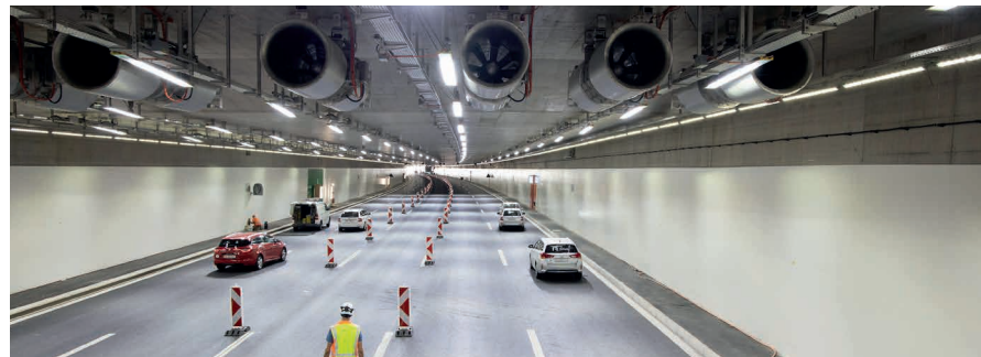
Die Lüftung in der Überdeckung Katzensee ist angebracht.
