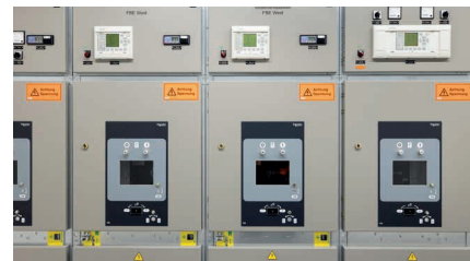
Schaltanlage für Mittelspannung.
