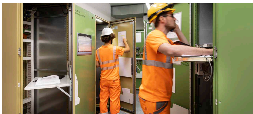
Blick in einen Raum der Betriebszentrale bei der Überdeckung Katzenssee.
