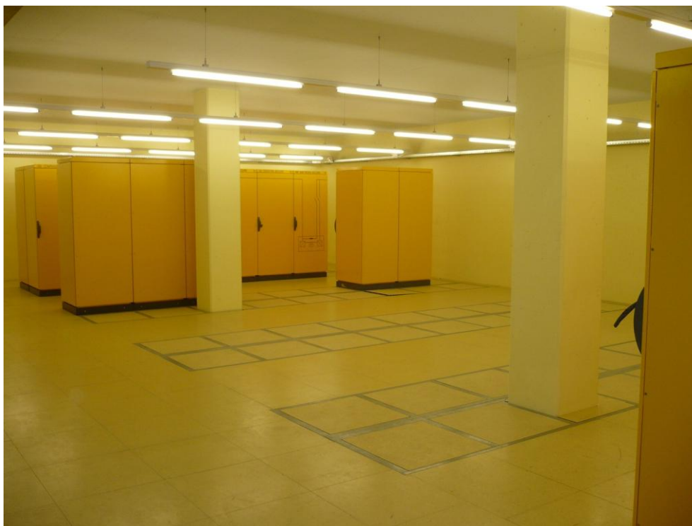
Abbildung 1: Beispiel von einer Zentrale
