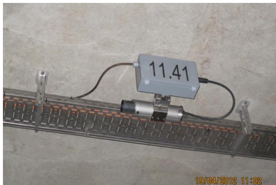
Kabelkanal mit Installation
