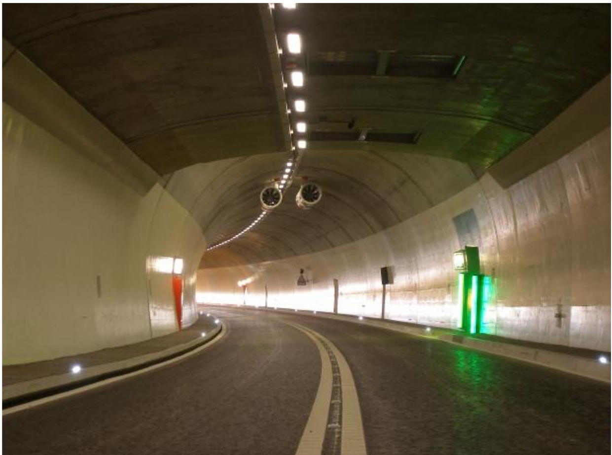
Abbildung 1: (Beispiel eines Tunnels mit Strahlventilatoren)
