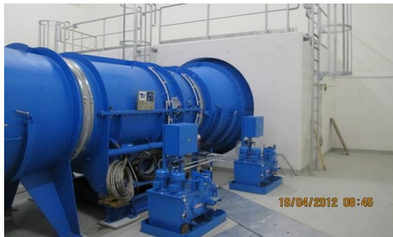
Lüftungszentrale (Innenseite des Ventilators: Korrosivitätskategorie C5)
