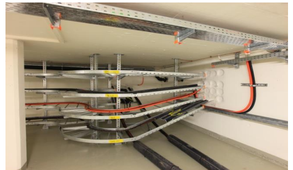
Kabelkeller mit Inhouse Kabelkanälen
