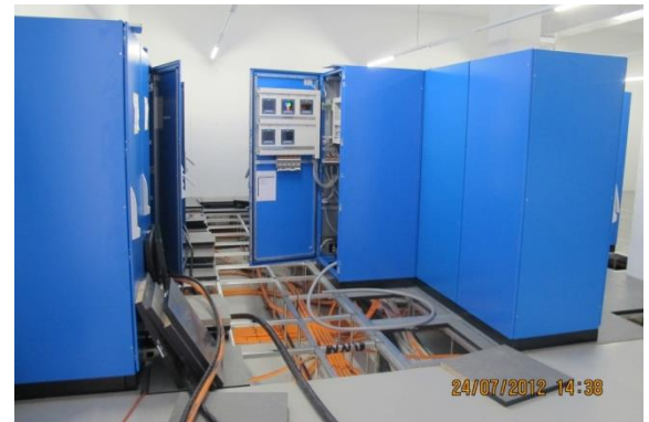
Raum mit Elektroinstallationen
