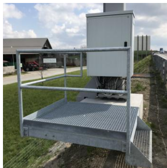
Abbildung 8: Verteil- und Steuerkasten (Beispiel)
