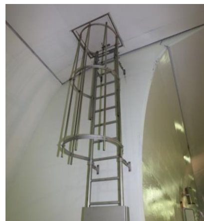
Aufstiegsleiter in Abluftkanal
