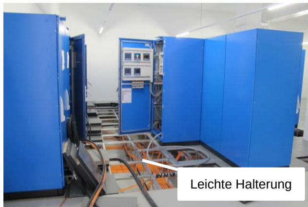
Bild 16: Elektroschränke auf Doppelboden
