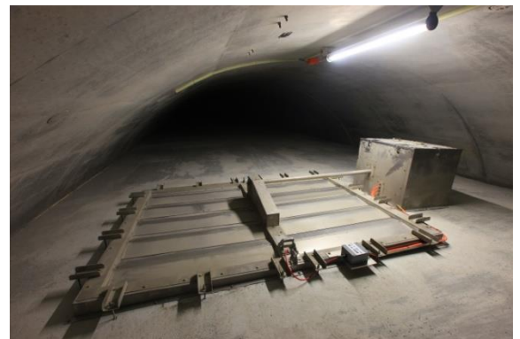
Abluftkanal mit Abluftklappe
