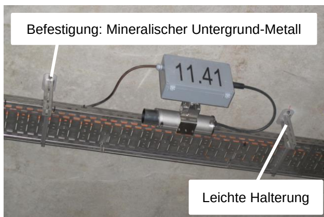
Bild 12: Kabelkanal an Tunneldecke
