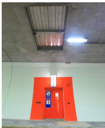
Tunnelbereich mit SOS-Nische, Abluftklappe
