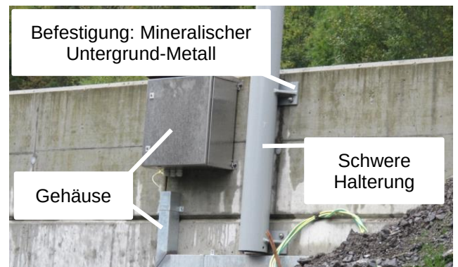
Bild 4: Unteres Ende Kameramast, Steuerkasten
