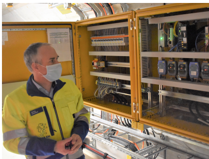
Georg Hiestand erklärt den Datentransfer zwischen Schaltschrank und Zentrale.
