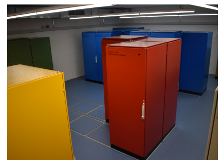
Farbige Schaltschränke machen es im Notfall einfacher, die Störung schnell zu finden.
