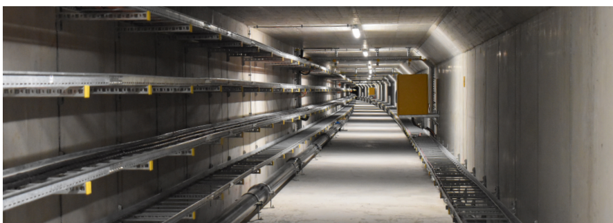
Der Werkleitungskanal der Überdeckung Katzenssee verbindet die beiden Betriebszentralen des 600 Meter langen Tunnels. Er verläuft seitlich zur Fahrbahn.
