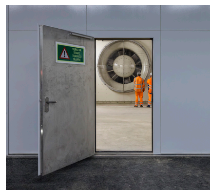
Blick zu den Axialventilatoren, welche die Rauchgase bei einem Ereignis ansaugen
