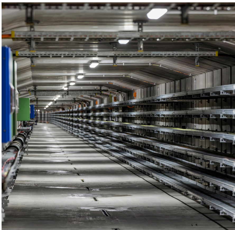
Unter der 2. Röhre: Aus Sicherheitsgründen werden verschiedenen Kabel getrennt und auf mehreren Trassen geführt
