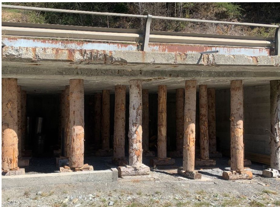
Pont Garin zwischen Liddes und Bourg-St. Pierre, provisorische Abstützung unter dem Bauwerk.
