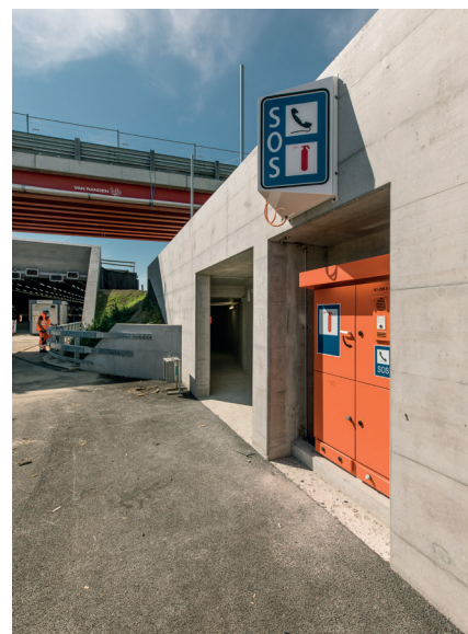
Die SOS-Station vor der Überdeckung Katzenssee ist einsatzbereit.
