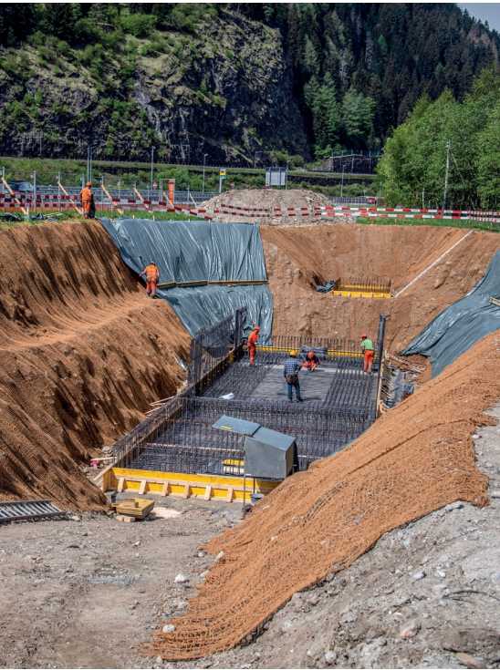
Impianto di depurazione delle acque SABA a Piotta.
