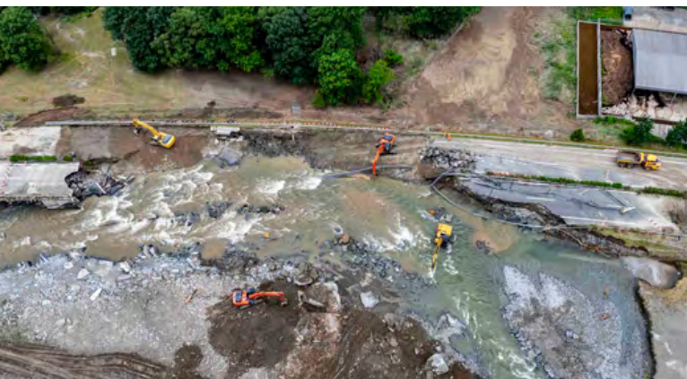
Im Sommer 2024 wurde die A13 im Misox im Kanton Graubünden unterspült. Die rasche Instandsetzung verhinderte grössere wirtschaftliche Schäden.
