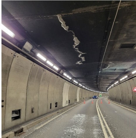
Abb. 8.24 Schadensfall an einer Zwischendecke [Quelle: Lombardi AG]
