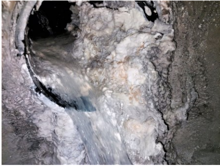
Abb. 9.26 Versinterung in einer Bergwasserdrainageleitung
