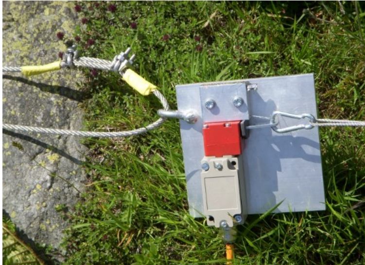
Abb. 7.113 Reissleinschalter zur Überwachung eines Murganggrabens [132]
