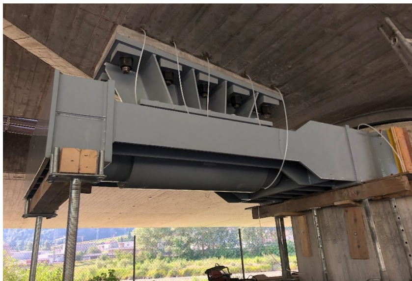
Abb. 4.8 Zwischen dem tragenden Element der Brücke und dem Pfeiler eingefügter Dämpfer mit in Längsrichtung beweglicher Abstützung (Brücke über die Rhône in Riddes).
