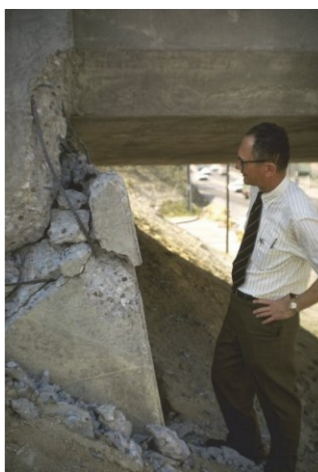
Abb. 3.14 Versagen des Widerlagers, I-5/I-210 Interchange, Erdbeben von San-Fernando 1971. (Quelle: NISEE-PEER, Univ. of California, Berkeley [99]).
