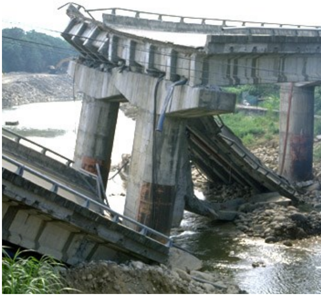
Abb. 3.2 Absturz der Brückenträger einer vorfabrizierten Balkenbrücke beim Erdbeben in Taiwan 1999 [30].
