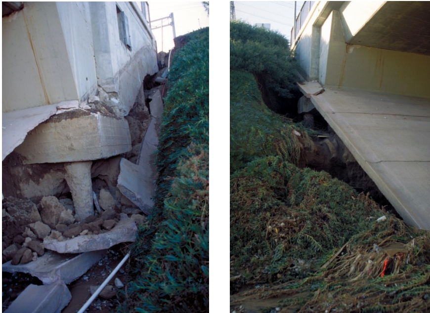
Abb. 3.13 Beschädigung des Widerlagers durch Setzungen (NISEE-PEER, Univ. of California, Berkeley, [55]).
