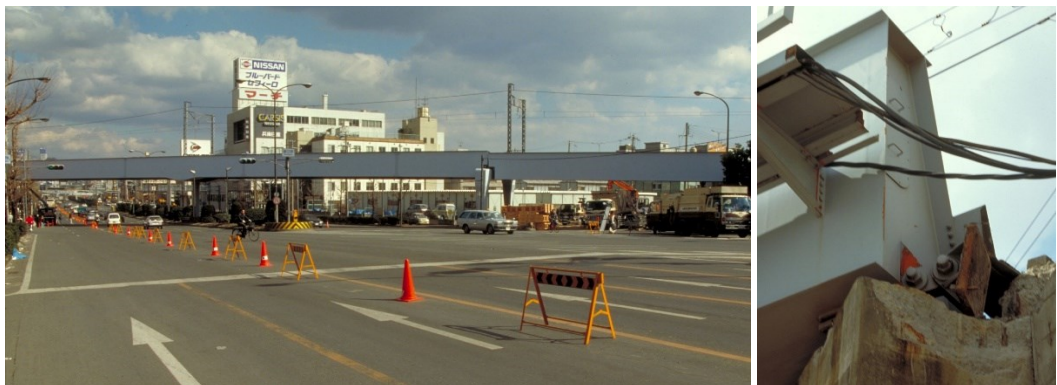
Abb. 3.8 Dreifeldträger mit fester Längslagerung am Widerlager am rechten Bildrand (links), Detail des abgerissenen festen Längslagers auf dem Widerlager (rechts), nach dem Erdbeben in Kobe 1995 [30].
