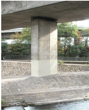
Abb. 4.5 Stark reduziertes horizontales Verformungsvermögen einer Stütze infolge der massiven Pflasterung des Flussbords [30].
