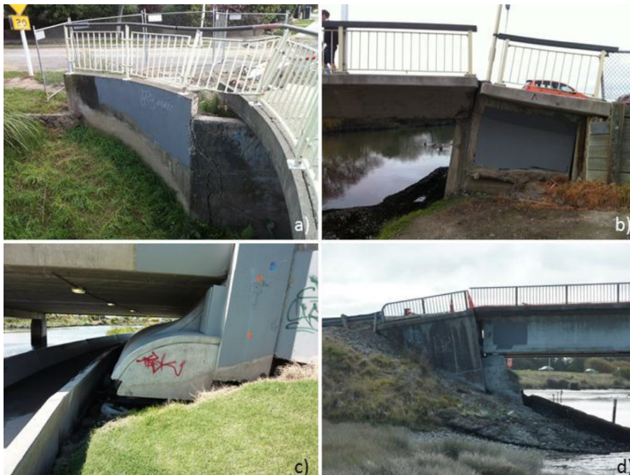
Abb. 3.17 Beispiele für Brückenschäden nach dem Erdbeben von Christchurch a) nördliches Widerlager der Brücke der Strasse Gayhurst; b) südliches Widerlager der Brücke der Strasse Avondale; c) südliches Widerlager der Brücke an der Promenade ANZAC; d) westliches Widerlager der Brücke South Brighton [105].
