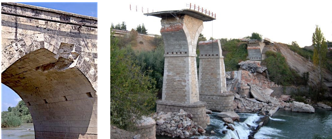
Abb. 3.7 Beschädigte Naturstein-Bogenbrücke beim Erdbeben von Ceyhan in der Südtürkei 1998 (links) [30], eingestürzte Naturstein-Bogenbrücke Rio Claro beim Centro-Sur-Erdbeben in Chile 2010 (rechts).
