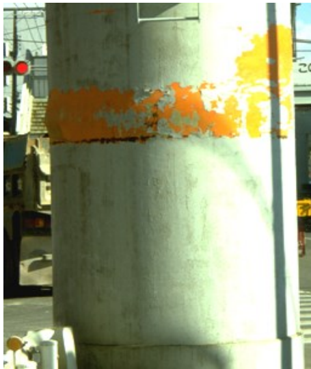
Abb. 3.5 Beulen einer runden Stahlstütze beim Erdbeben in Kobe 1995 [30].
