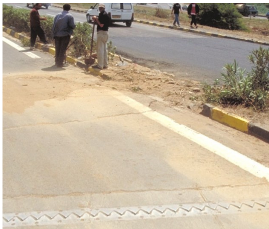
Abb. 3.12 Geringfügige Setzungen hinter dem Widerlager einer Strassenbrücke in Boumerdès, Algerien 2003 [30].
