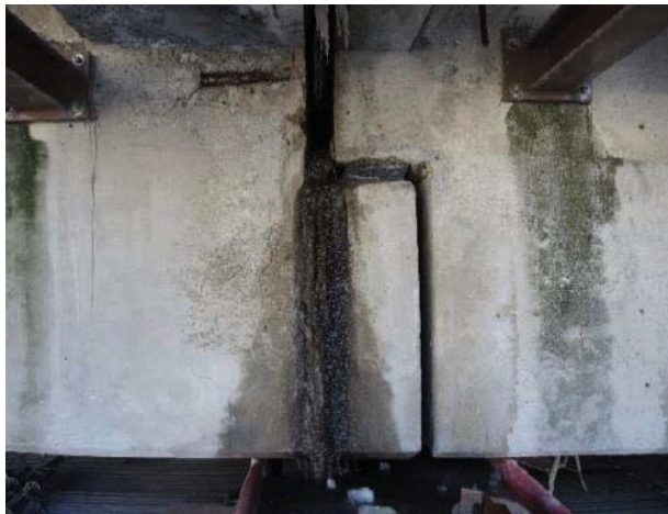
Abb. 4.2 Gerbergelenk mit zu kurzer Auflagerlänge (Chocolatière-Viadukt über die N09, heute Pont sur le Flon genannt, vor der Sanierung und Verbreiterung der Gerber Auflagerbank).
