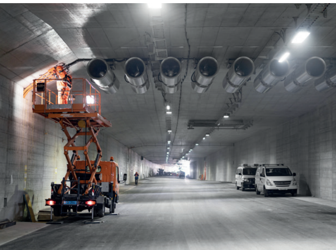
Strahlventilatoren in der Einhausung Schwamendingen.
