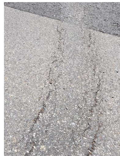
Abbildung 16: Dellen im Asphalt
