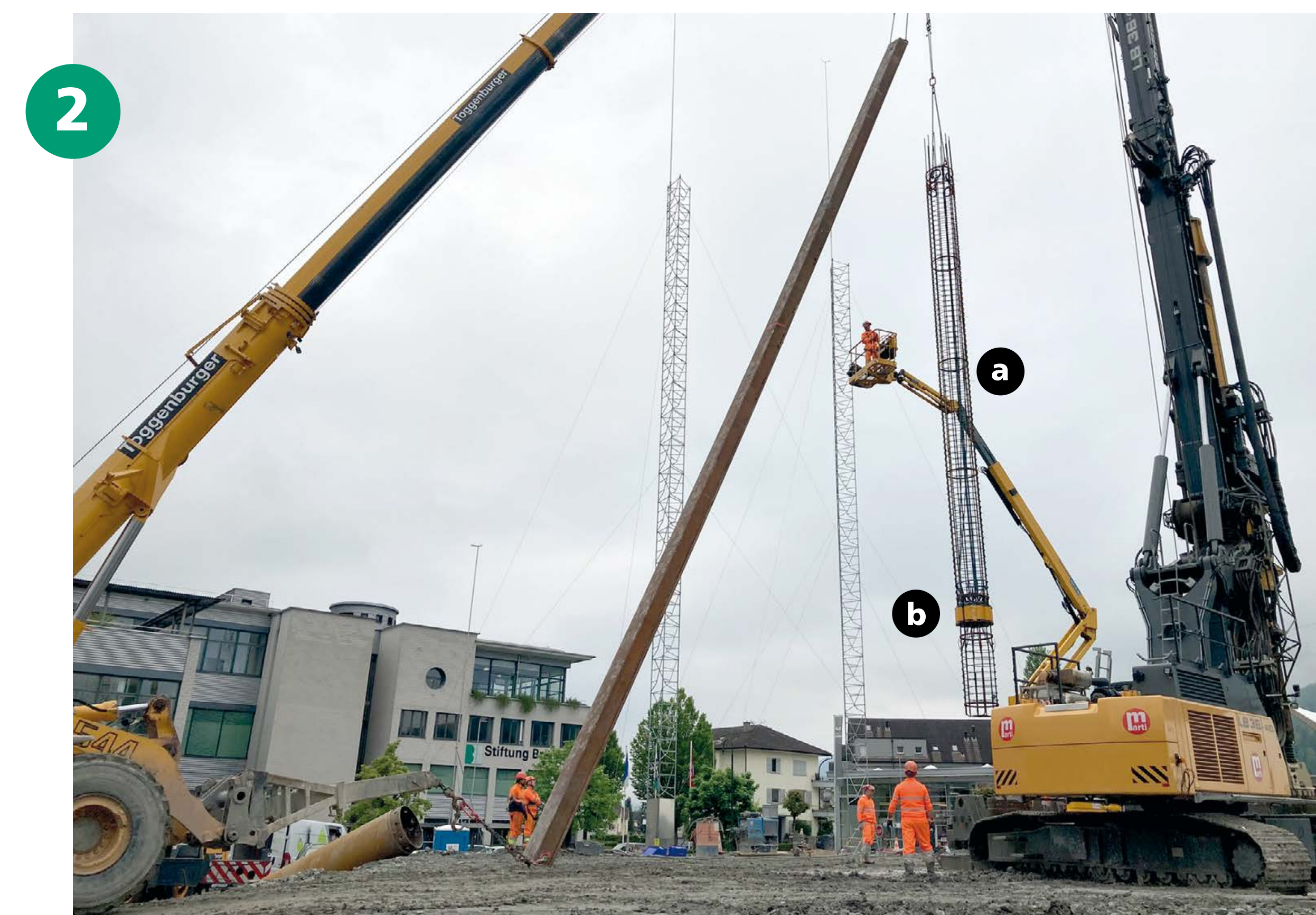
Der Bewehrungskorb (a) mit hydraulischer Presse (b) kurz vor dem Einbringen in das Bohrloch (Archivbild).
