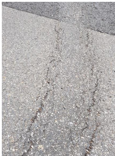
Abbildung 14: Dellen im Asphalt
