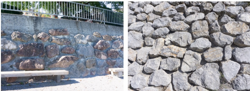
Abb. 12 Fehlende Lagerhaftigkeit bei Blockwurfmauern
