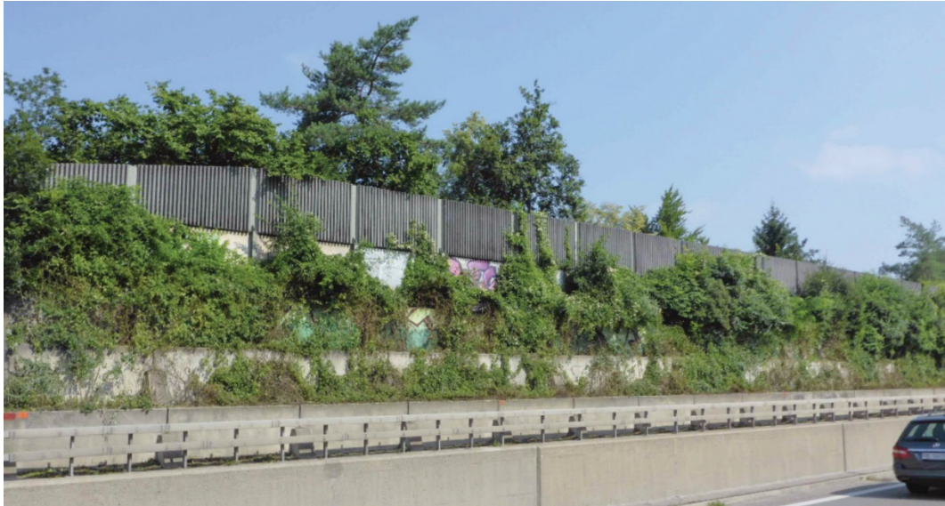
Abb. 1 Unruhiges Gesamtbild durch eine Vielzahl an Bauwerksbestandteilen
