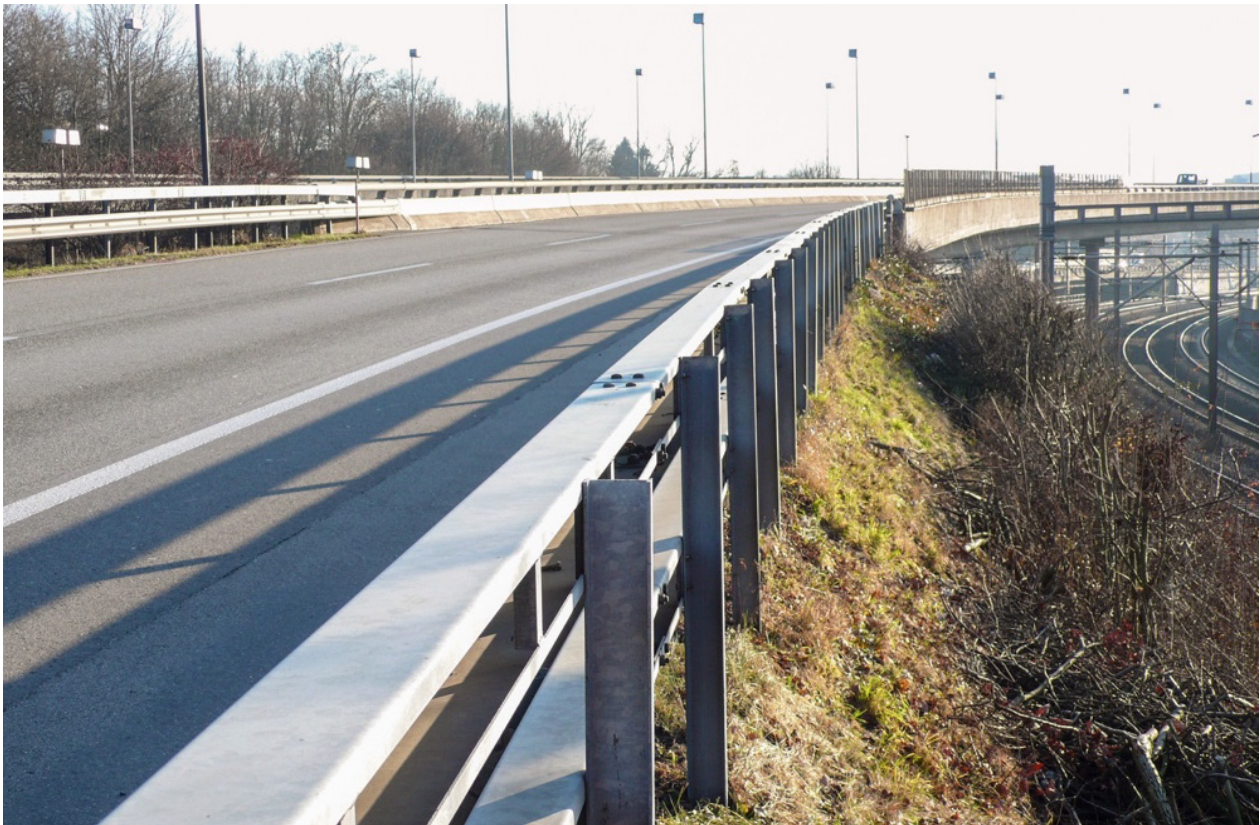
Photo 2 : Dispositifs de retenue des véhicules le long de la tangente de Berne
