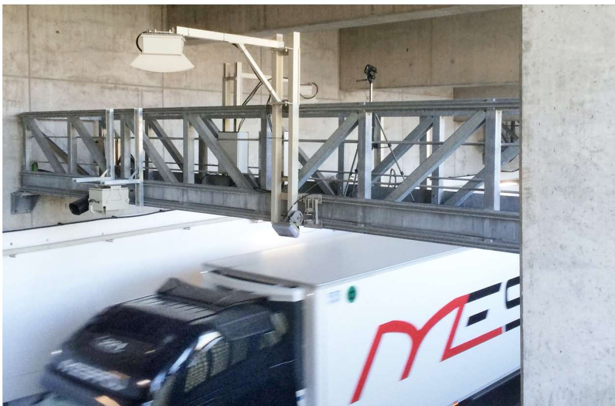
Photo 6 : Installations de monitoring des marchandises dangereuses au col du Simplon
