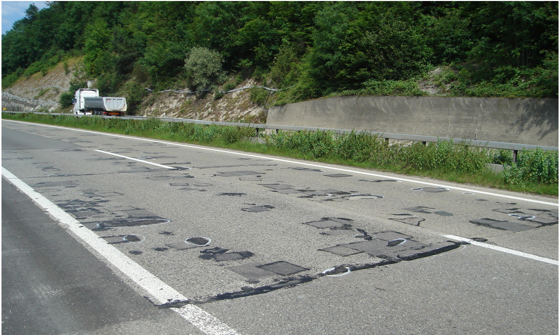
Fig. 57: Rapiéçage du revêtement après plusieurs réparations
