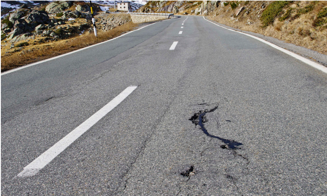
Fig. 54: Nid-de-poule partiellement réparé avec du bitume
