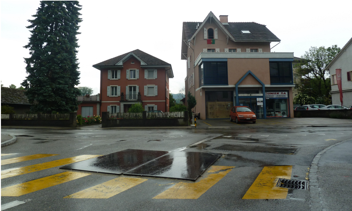
Fig. 36: Mauvais exemple de couverture d'une tranchée
