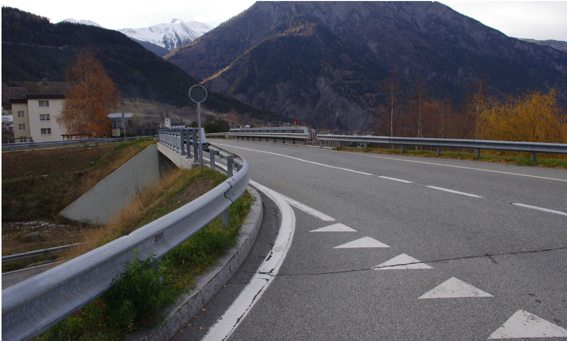
Fig. 34: Diminution de la visibilité due à un dispositif de retenue de véhicules
