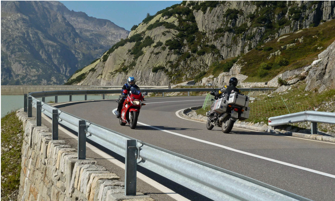
Fig. 85: Dispositif de retenue de véhicules avec poteaux (IPE) et profil longitudinal
