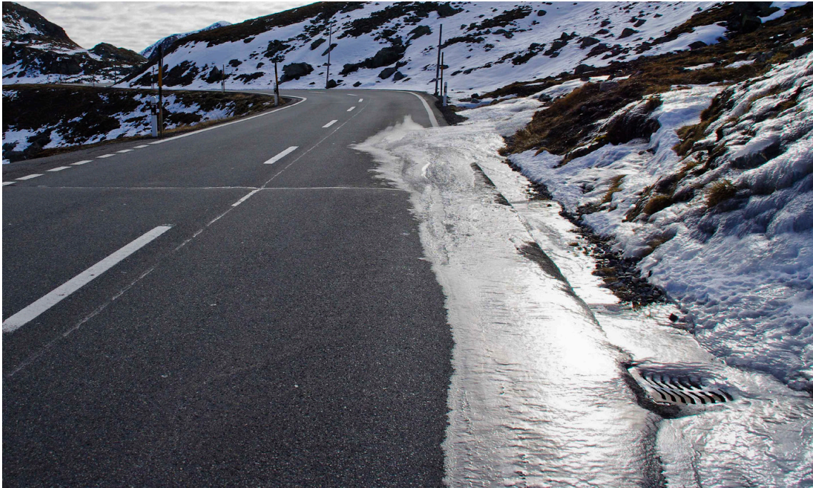
Fig. 71: Chaussée verglacée en raison d'une évacuation insuffisante des eaux de la fonte des neiges
