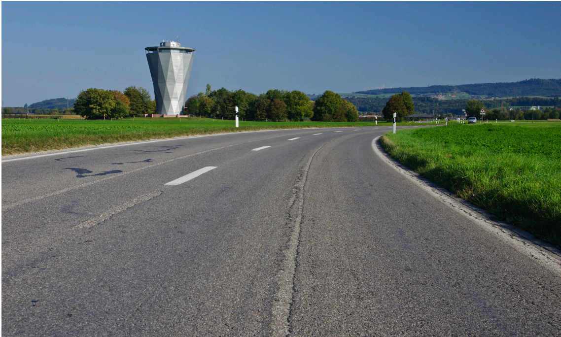
Fig. 63: Ornière au milieu de la voie (à cause d'une mauvaise exécution des travaux de réfection du revêtement)
