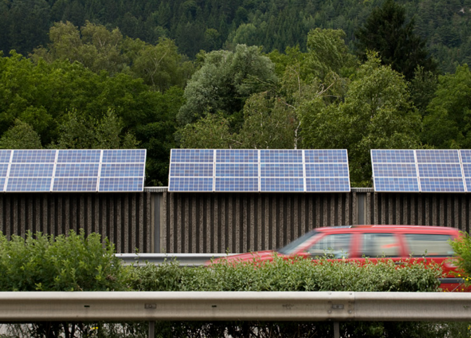
Paroi photovoltaïque anti-bruit le long de l'autoroute A13, près de Domat-Ems.
