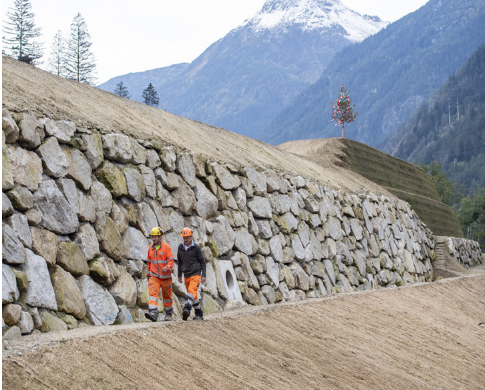
Digue de protection le long de l'autoroute A2 entre Amsteg et Göschenen
