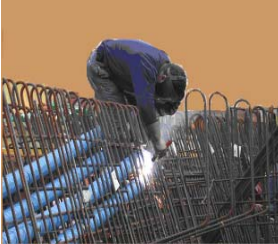
Fig. II.17 Soudage sans mesure de protection est interdit.
