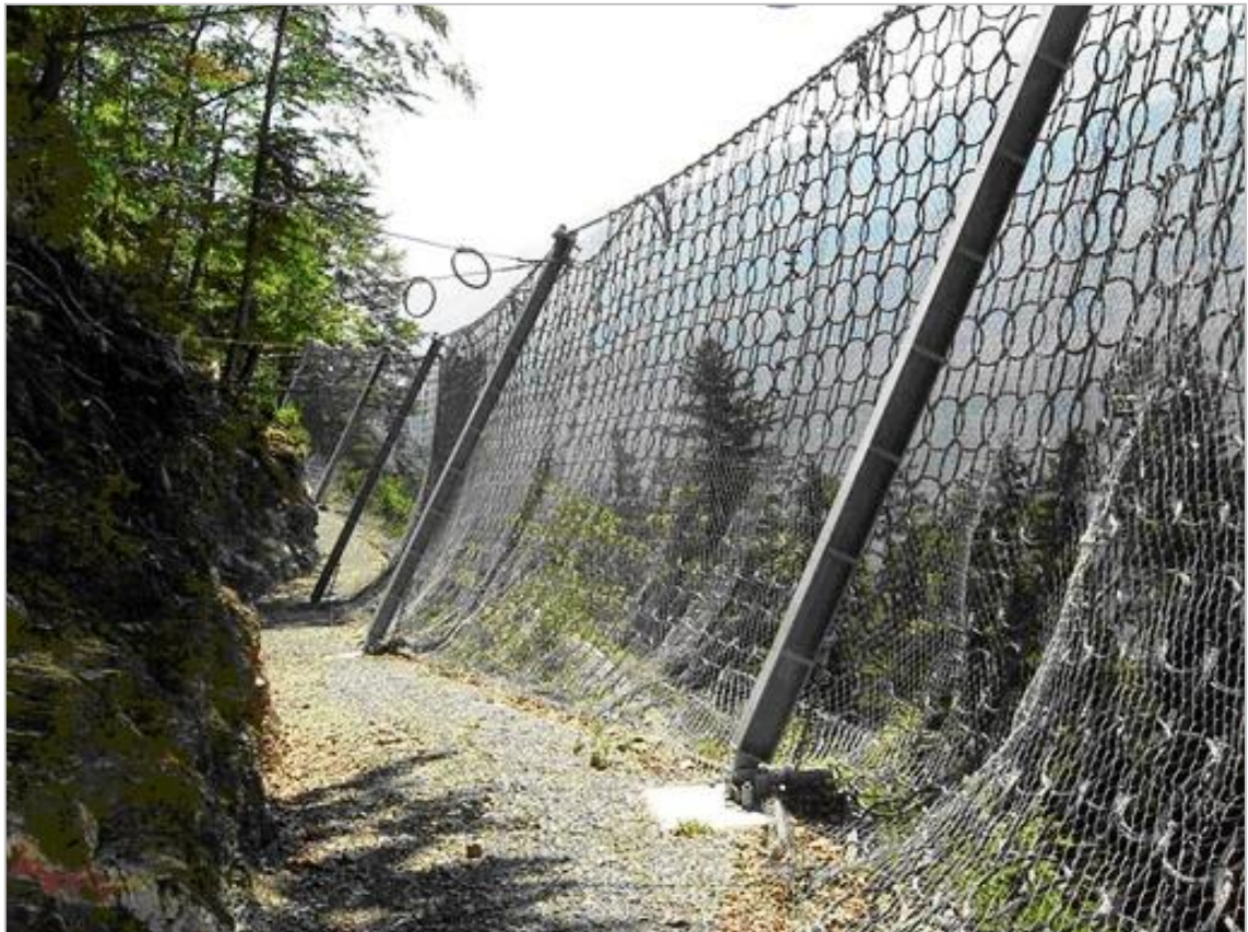
Figure 1: Filet de protection contre les chutes de pierres et son chemin de service
