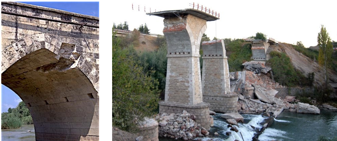
Fig. 3.7 Pont-arc en pierres naturelles endommagé lors du tremblement de terre de Cehan dans le sud de la Turquie en 1998 [30] (à gauche), pont-arc en pierres naturelles sur le Rio Claro effondré lors du séisme de Centro-Sur au Chili en 2010, source K. Beyer (à droite).
