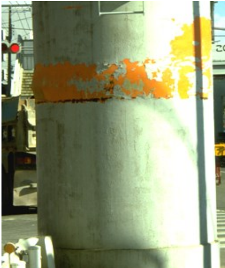
Fig. 3.5 Voilement d'une pile métallique ronde lors du tremblement de terre de Kobe en 1995 [30].
