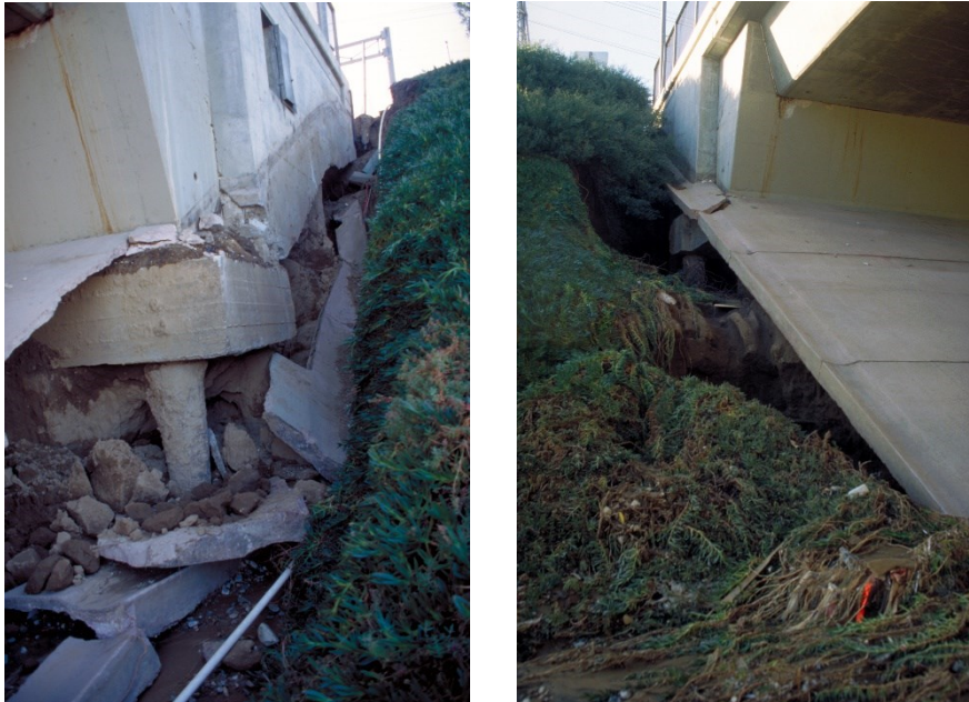
Fig. 3.13 Endommagement de la culée à cause de tassements (NISEE-PEER, Univ. of California, Berkeley, [55]).
