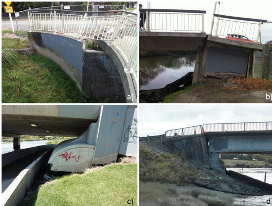
Fig. 3.17 Exemples de dommages de pont suite au tremblement de terre de Christchurch a) culée nord du pont du chemin Gayhurst; b) culée sud du pont du chemin Avondale; c) culée sud du pont de la promenade ANZAC; d) Culée ouest du pont South Brighton [105].
