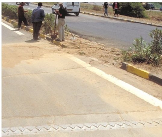
Fig. 3.12 Tassements faibles derrière la culée d'un pont-route à Boumerdès, Algérie, en 2003 [30].
