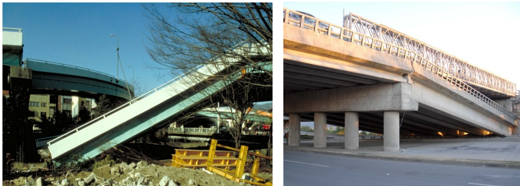
Fig. 3.1 Chute du tablier d'un pont lors du tremblement de terre de Kobe en 1995 (à gauche) et au Chili en 2010 (à droite) [30].
