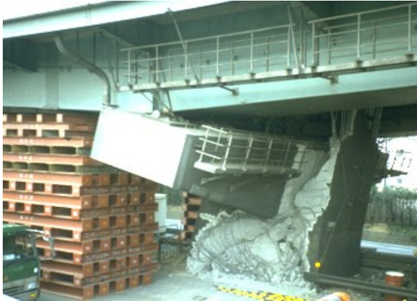
Fig. 3.6 Ruine à l'effort tranchant d'une pile de pont en béton armé lors du tremblement de terre de Kobe en 1995 [30].
