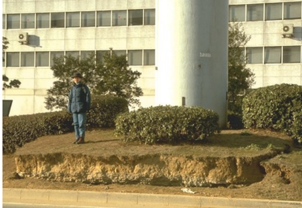
Fig. 3.16 Tassements généralisés causés par la liquéfaction du sol autour de la dalle de fondation sur pieu d'une pile de pont, Kobe, 1995 [30].
