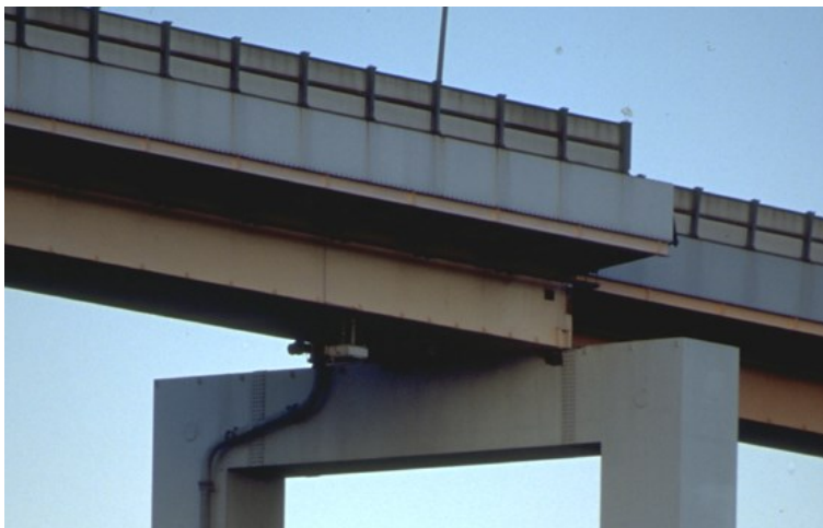
Fig. 3.3 Déplacement latéral du tablier et chute des appuis sur la palée d'une pile à Kobe en 1995 [30].
