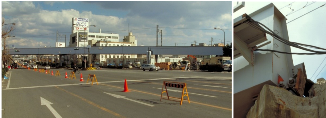
Fig. 3.8 Ponts à trois travées avec appuis fixes à la culée à droite de l'image (image de gauche). Appui longitudinal arraché, sur la culée d'un pont-poutre, Kobe 1995 [30] (à droite).
