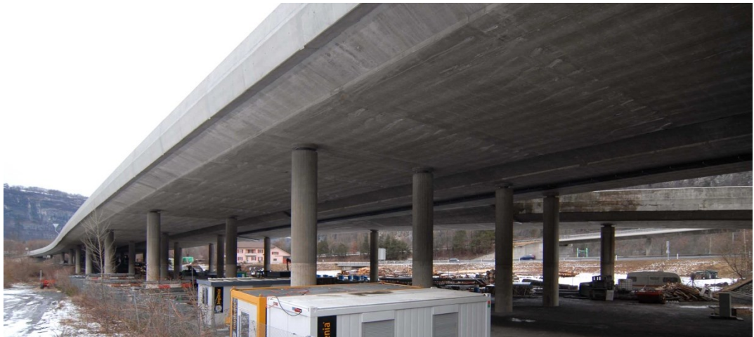
Fig. 10.9 Vue des ponts jumeaux du Bois-Homogène, avec les deux ponts à rampe.
