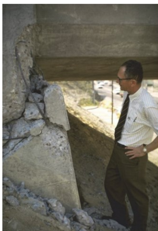
Fig. 3.14 Rupture de la culée, I-5/I-210 Interchange, séisme de San-Fernando 1971. (Source: NISEE-PEER, Univ. of California, Berkeley [99], repris du rapport AGB 663 [34]).
