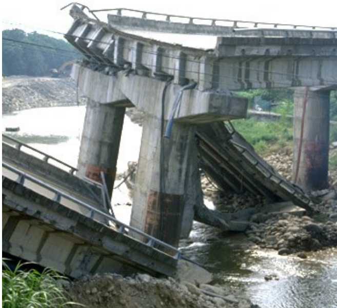
Fig. 3.2 Effondrement du tablier d'un pont à poutres préfabriquées lors du tremblement de terre de Taiwan en 1999 [30].
