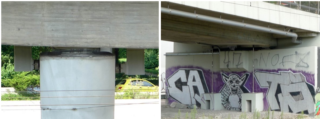
Fig. 10.7 Confortement en passant d'appuis longitudinaux fixes à flottants : pile convertie avec tiges verticales comme appuis de traction (à droite) ; nouvelles comes latérales sur l'un des deux supports centraux (à gauche).
