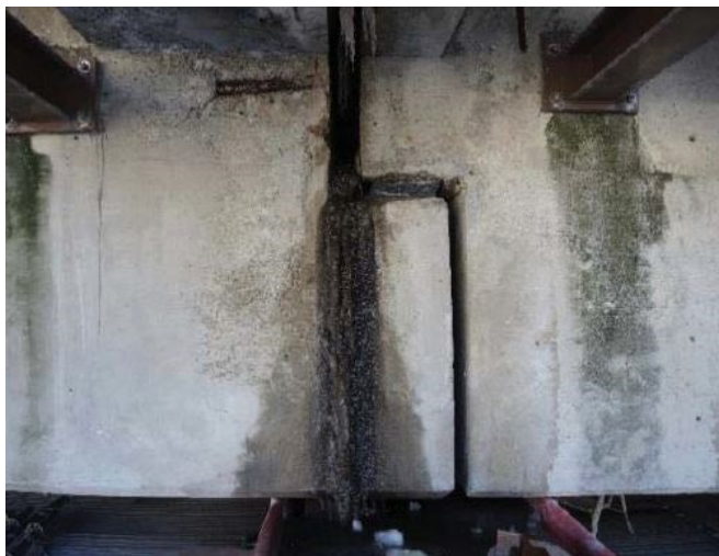
Fig. 4.2 Articulation Gerber avec longueur d'appui trop courte (viaduc de la Chocolatière sur la N09, aujourd'hui appelé Pont sur le Flon, avant l'assainissement et l'élargissement du banc d'appui Gerber).
