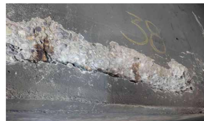
Das hohe Verkehrsaufkommen, der Bahnverkehr über dem Tunnel und der Einsatz von Salz für den Winterdienst haben den Querträgern sichtbar zugesetzt.
