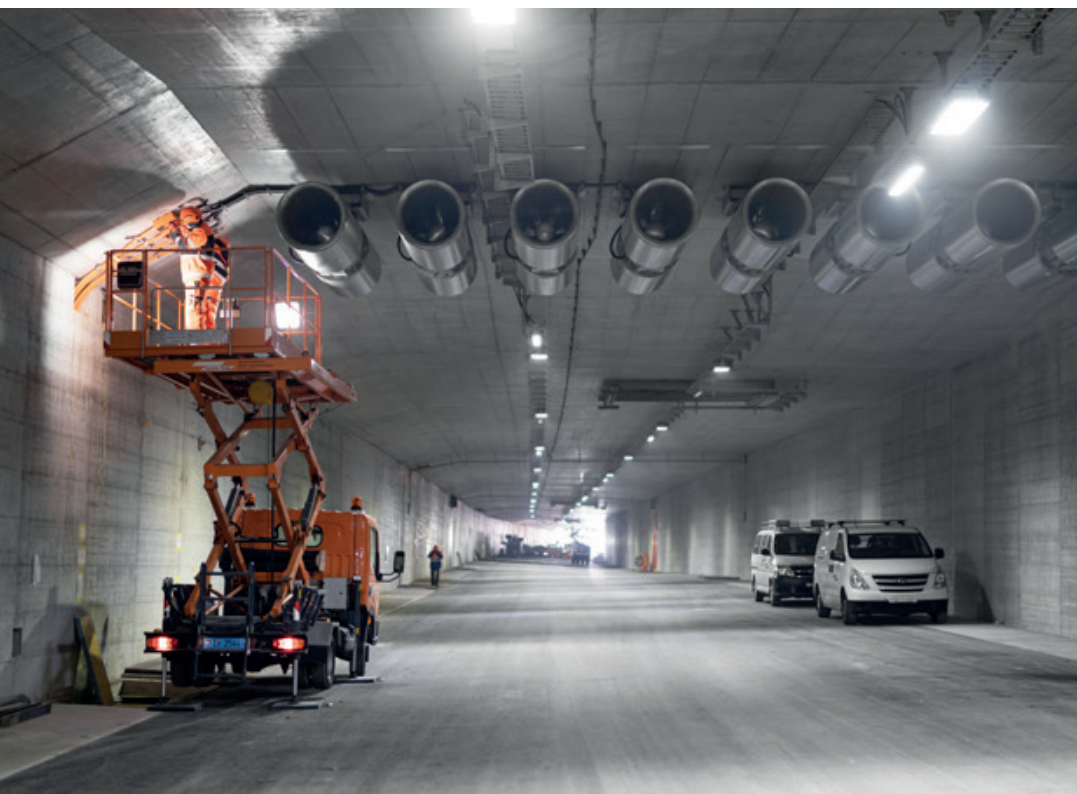
Turbo-ventilateurs dans la tranchée couverte de Schwamendingen.
