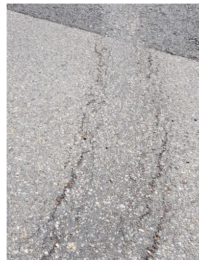
Abbildung 16: Dellen im Asphalt
